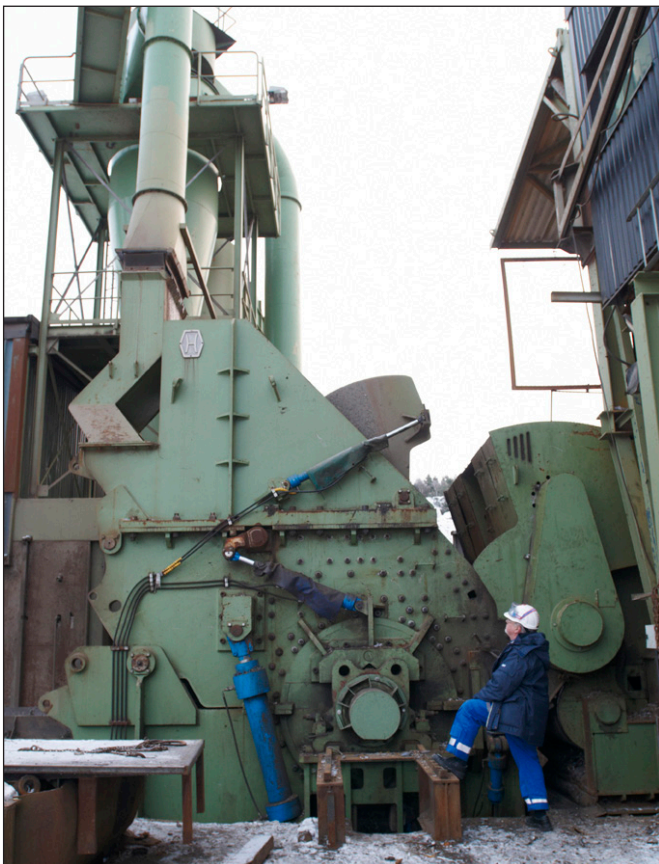
Sättningsskador på skrotfragmenteringsmaskinens fundament för el-motorn med växellåda.
